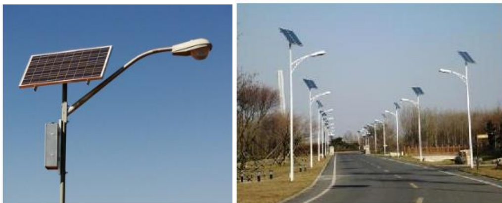
Figura 8.12 – Iluminação pública através de painéis solares
