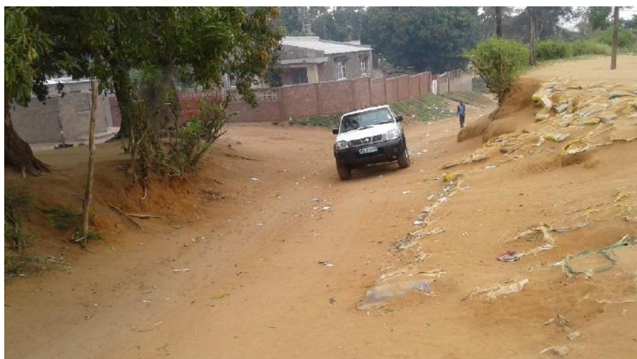
Figura 6.21 – Exemplo de erosão junto a uma estrada.
