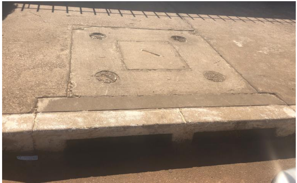
Figura 6.32 – Sumidouro duplo em estrada do centro da cidade
